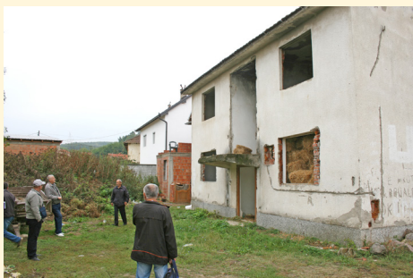
Оштећена кућа у Д. Србици
